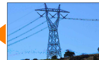
Réseau électrique EDF
